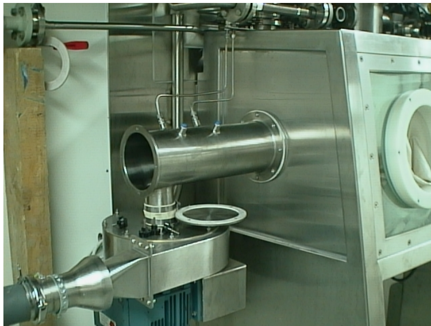
Fig. 4 dettaglio del sistema di filtrazione dell'aria espulsa e del relativo ventilatore che mantiene la depressione in un isolatore
